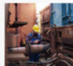
Mantenimiento de equipos Industriales
